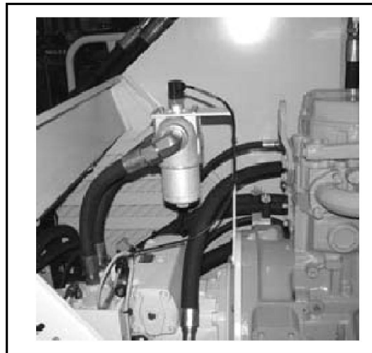
Рисунок 8.11: Фильтр насоса привода дробилки
